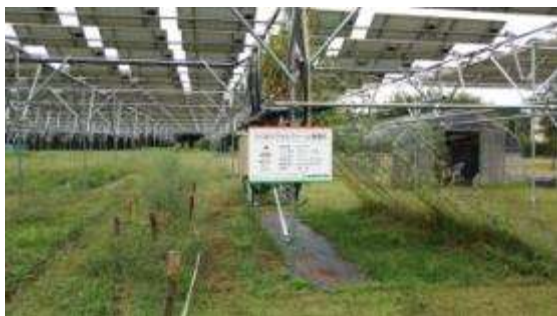
写真1 つくばソラカルファーム発電所
